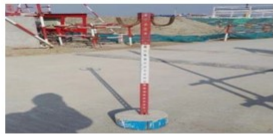
Cable rack 电缆线线架
